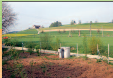
Suisse, Bätterkinden. Traitement des solvants chlorés. Vue de la porte filtrante.
