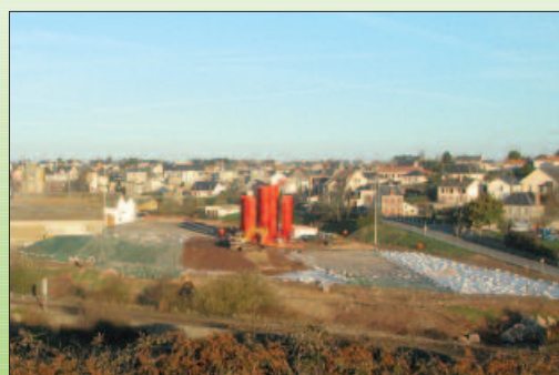
Alvéoles de stockage sur site et traitement des eaux souterraines.
